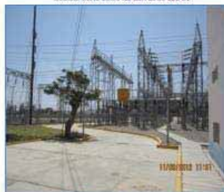
Patio de Llaves 60 kv- S.E.Independencia
