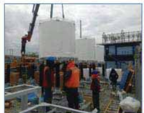
Banco de Condensadores en la S.E. Zorritos
