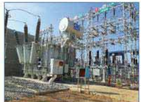
Transformador de 50 MVA instalado en la S.E. Zorritos
