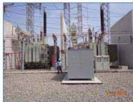
Resistencia neutro Autotransformador. 500/220 kv S.E. Chilca
