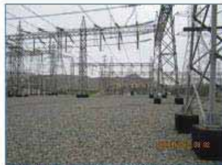
S.E. Chilca- Área para Reactor Serie y Celda de Conexión
