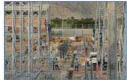
Ampliación S.E. Independencia 60 kV
