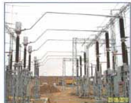
S.E. Trujillo Norte
