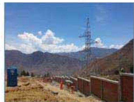
Muro Perimetral de la S.E. Amarilis 138 kV y Torre N° 1 a S.E. Piedra Blanca (L-1121)
