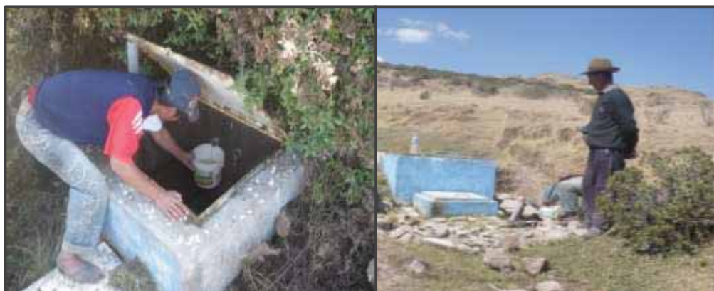
Fotografía 24. Hidrante en uso e hidrante colmatado
