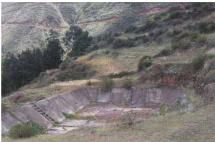
Fotografía 27. Reservorio de la parte media falta de mantenimiento
