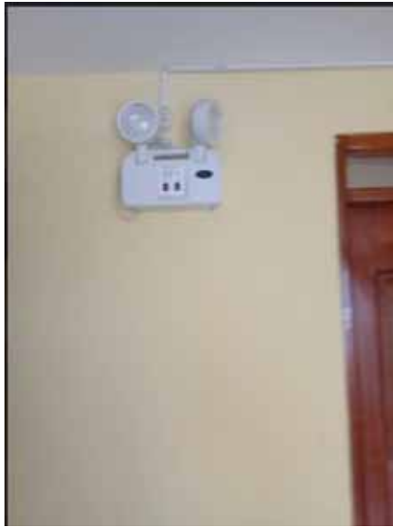
Luces de emergencia
