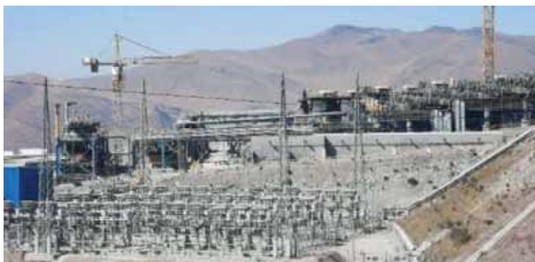
Figura n° 40: Subestación de planta concentradora
