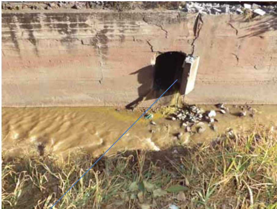
Notorio Vertimiento de descarga de desagüe ubicado en el Mercado El Molino I en el distrito de Wanchaq de la Provincia del Cusco. Vista tomada el 12/07/17.
