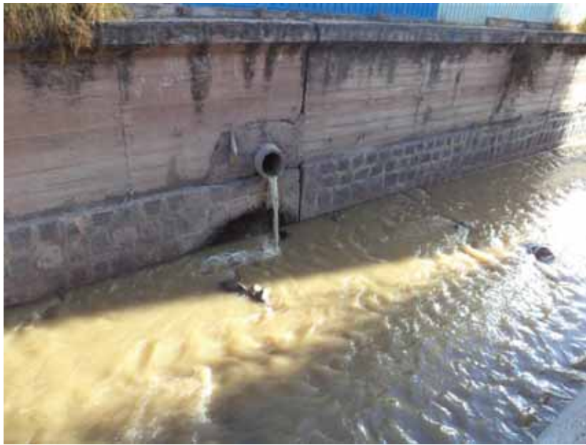
Vertimiento de Agua Residual en el mercado de El Molino I, ubicado en el distrito de Wanchaq , Provincia del Cusco. Vista tomada el 12/07/17.
