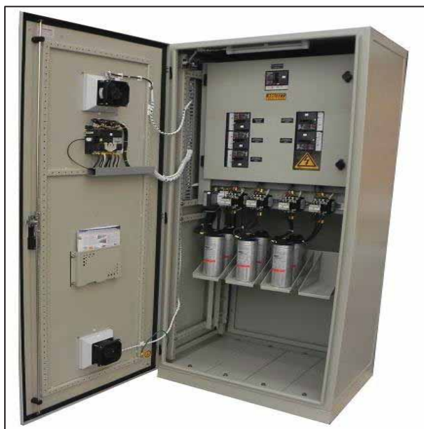
Figura 0.15 Banco de Condensadores Automático
