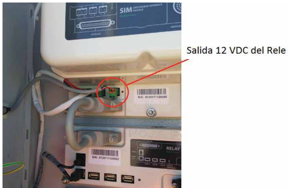
Figura 33: Alimentación eléctrica del modem a 12 VDC
