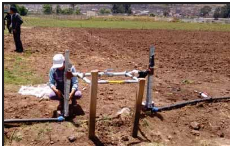
Fotografía 10. Vista del cabezal de riego en el campo experimental.
