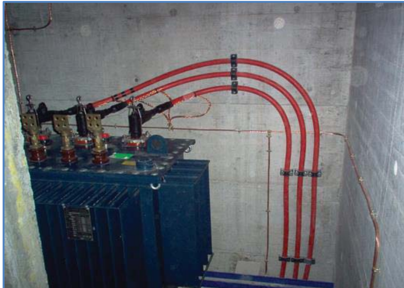
Figura 11: Subestación Sub Terranea.
