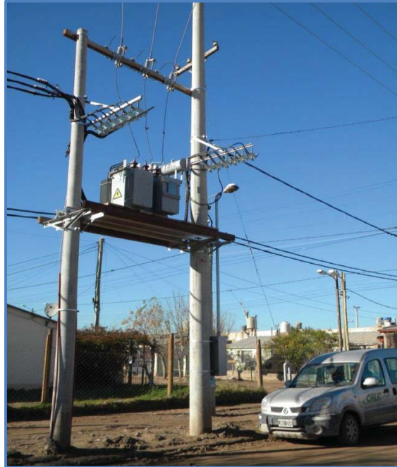
Figura 13: Subestación del tipo Biposte.
