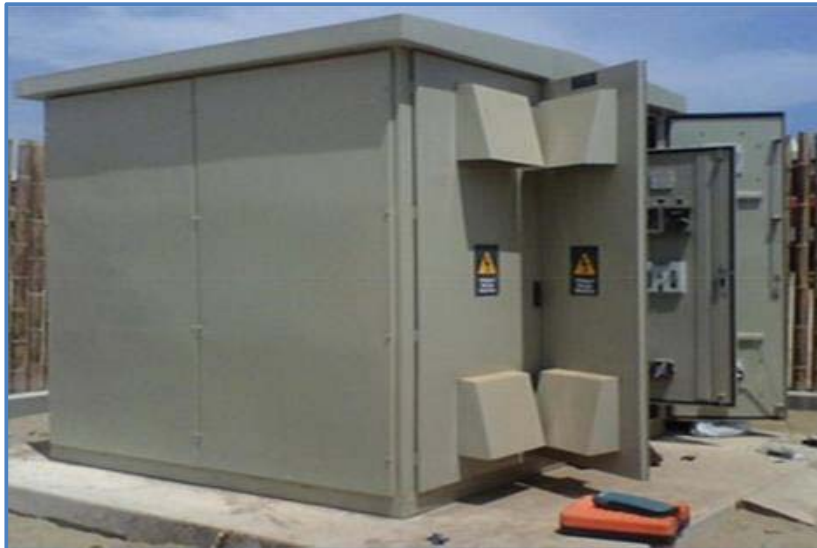
Figura 10: Subestación en caseta nivel del piso.
