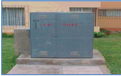
Figura 14: Subestación compacta parte exterior
