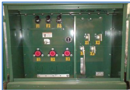
Figura 15: Subestación compacta parte interior.
