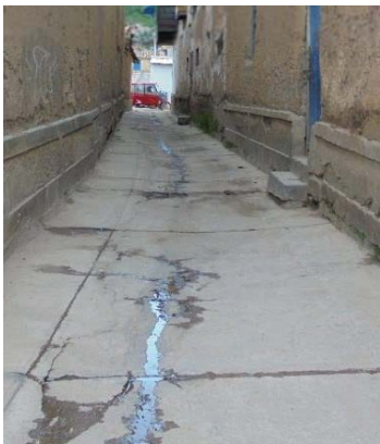
Imagen 45. Vías deterioradas en la calle del centro de la ciudad (Archivo propio-2017)
