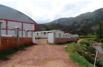
AGEN N° 01, Estado actual de la I.E. 50120 Pucyura. 2017 Archivo propio.
