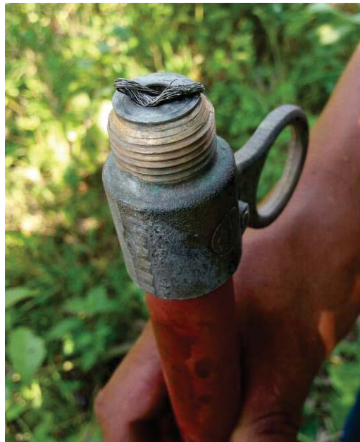
Figura 3.4.2. Fusible reemplazado por cable
