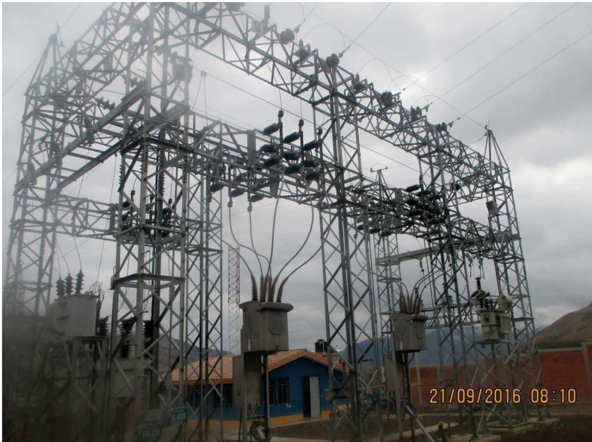
Figura 3.2.2. S.E. Paucartambo. Barra de 22.9 kV y salidas PA-01 y PA-02
