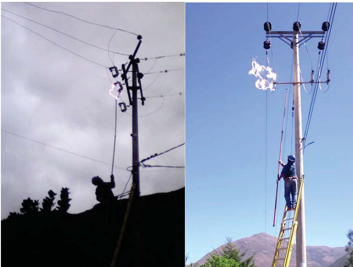
Figura 3.5.2. Maniobras de apertura (izquierda) y reposición de fusible (derecha), en el cual se puede ver los arcos eléctricos producidos por mala ejecución.
