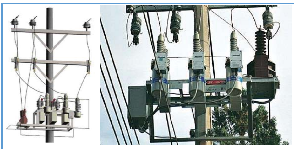
Figura N° 2.30 Banco de condensadores fijos en medio voltaje
