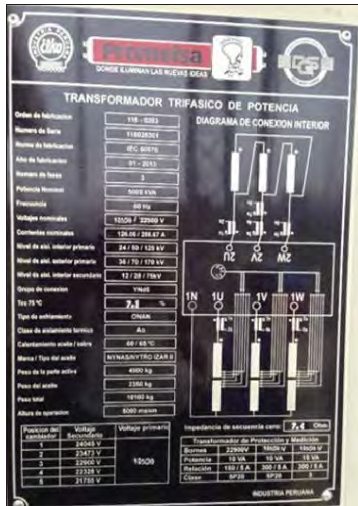
FIGURA 3.7 Placa de Características del Transformador de Potencia
