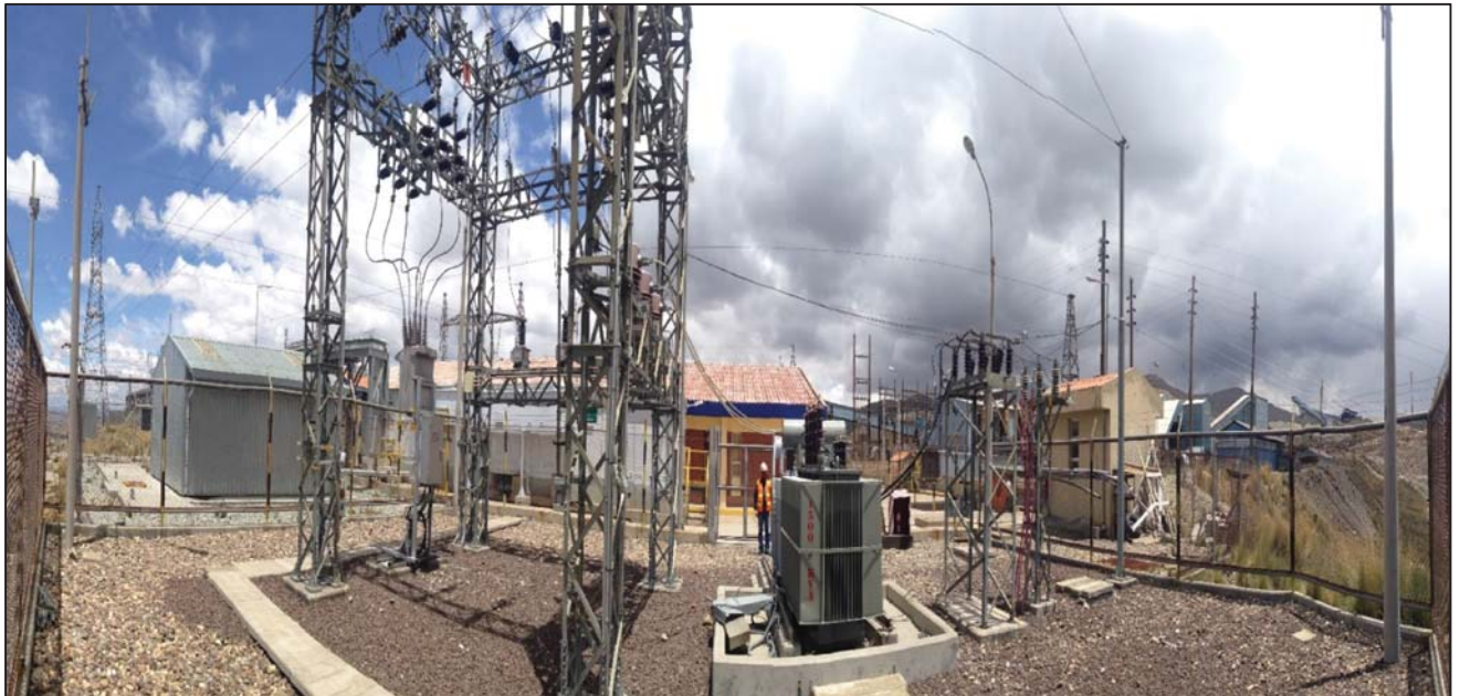
FIGURA 3.5 Vista Panorámica de la Subestación de Transformación Tintaya 10.5/22.9 kV.
