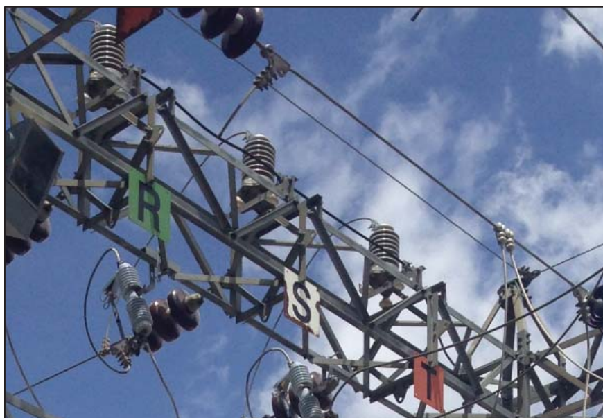
FIGURA 3.10 Pararrayos de la Subestación de Transformación 10.5/22.9 Kv Tintaya
