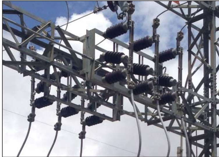
FIGURA 3.11 Seccionadores de Barra de la Subestación de Transformación Tintaya
