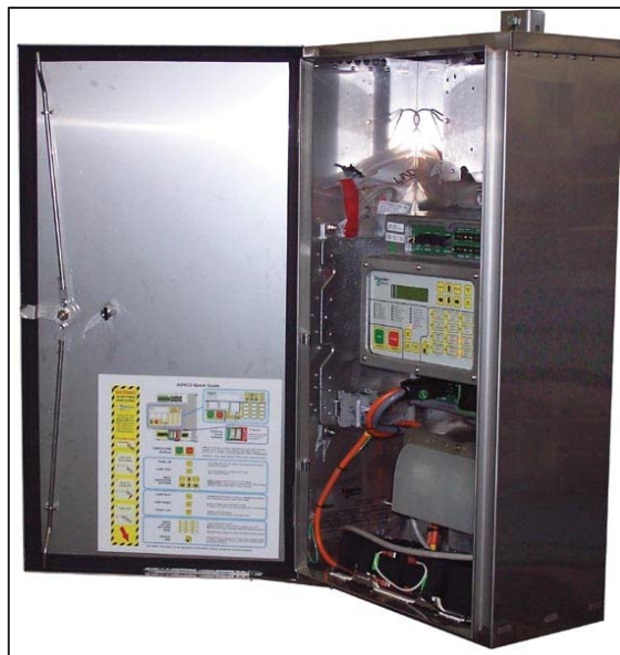
FIGURA 3.13 Controlador del Reconectador de la Subestación de Transformación 10.5/22.9 kV Tintaya (Lado 22.9 kV)
