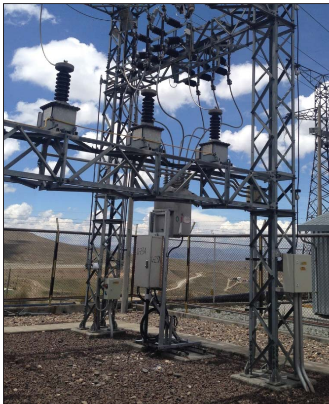
FIGURA 3.9 Transformadores de Tensión de la Subestación de Transformación Tintaya
