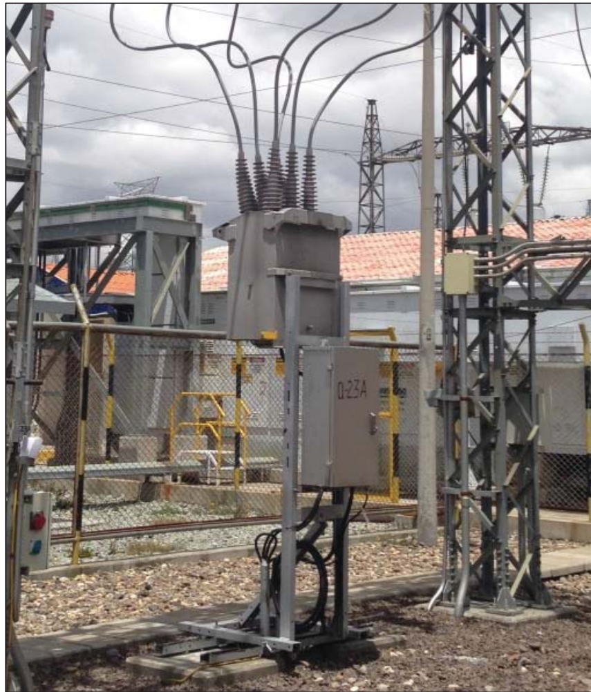
FIGURA 3.12 Reconectador IN-250 de la Subestación de Transformación Tintaya (Lado 22.9 kV.)
