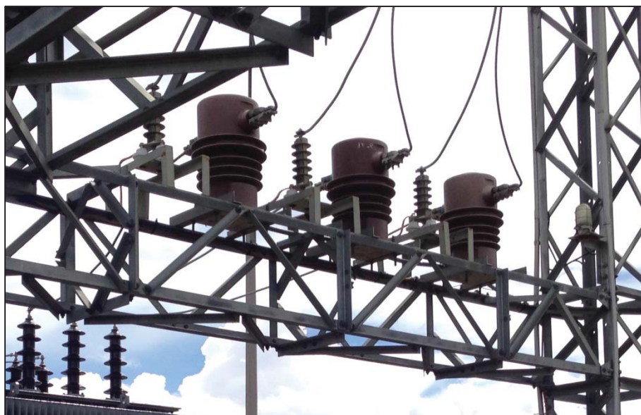
FIGURA 3.8 Transformadores de Corriente de la Subestación de Transformación Tintaya
