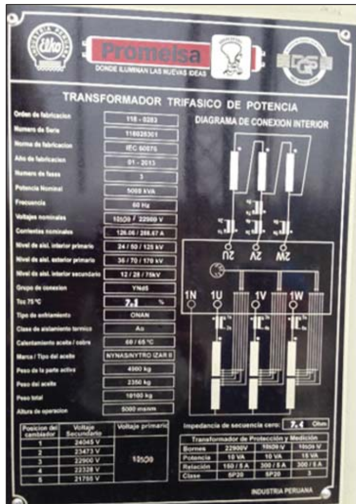
FIGURA 3.7 Placa de Características del Transformador de Potencia
