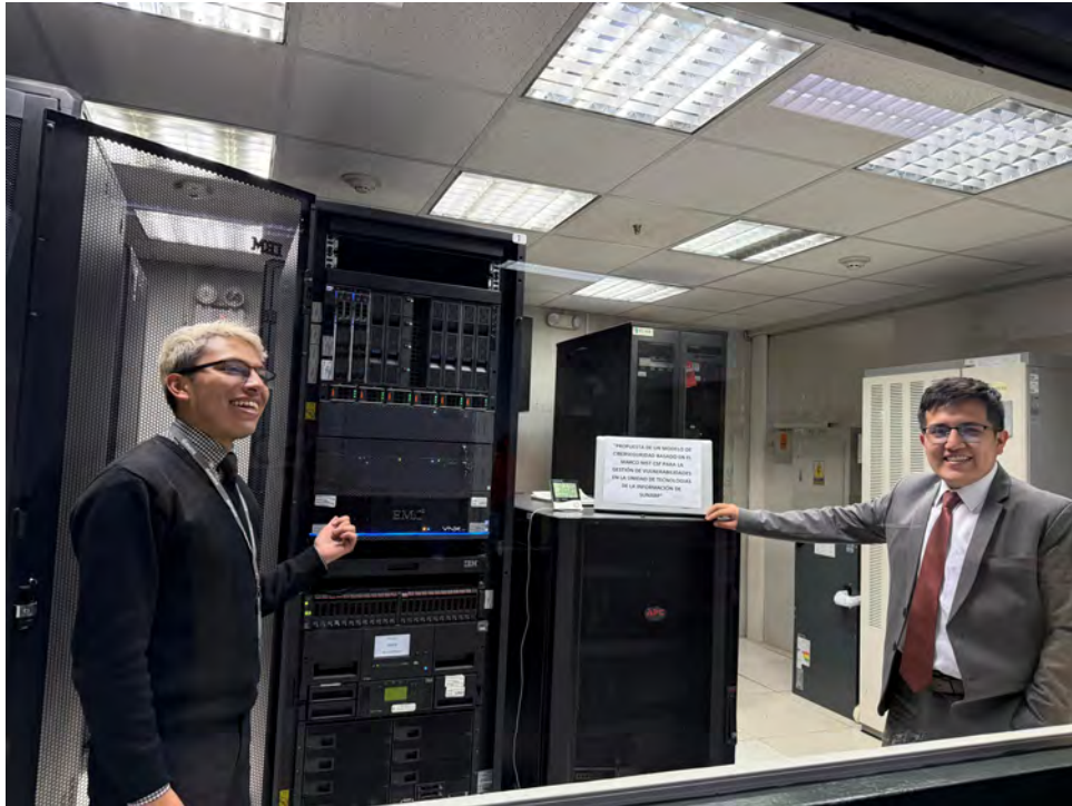
Nota. Captura obtenida durante la verificación del funcionamiento de los servidores en la UTI de SUNARP. Elaboración propia.
