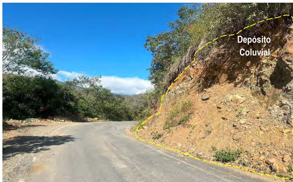
Fotografía 13: Depósito coluvial en taludes km 03+560
