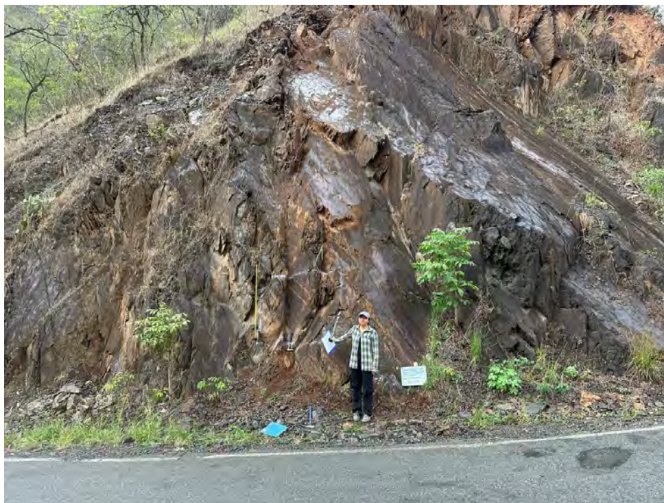
Fotografía 18: Caída de rocas en el km 4+900.
