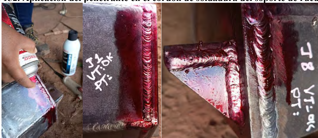
Figura 152. Aplicación del penetrante en el cordón de soldadura del soporte de rueda.
