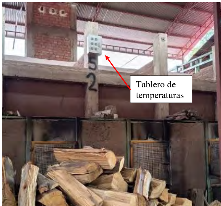
Figura 15. Tablero de indicadores de temperatura
