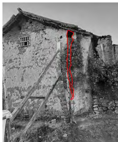
Fotografía 21: Grietas en el baptisterio
