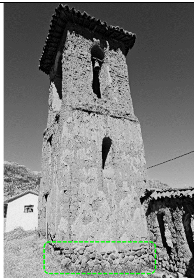
Fotografía 25: Perdida de material del sobrecimiento del campanario.
