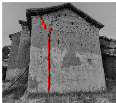
Fotografía 18: Grietas en la sacristía (a)
