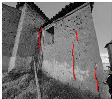
Fotografía 19: Grietas en la sacristía (b)
