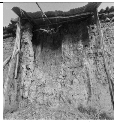
Fotografía 17: Desgaste del muro epístola (b)
