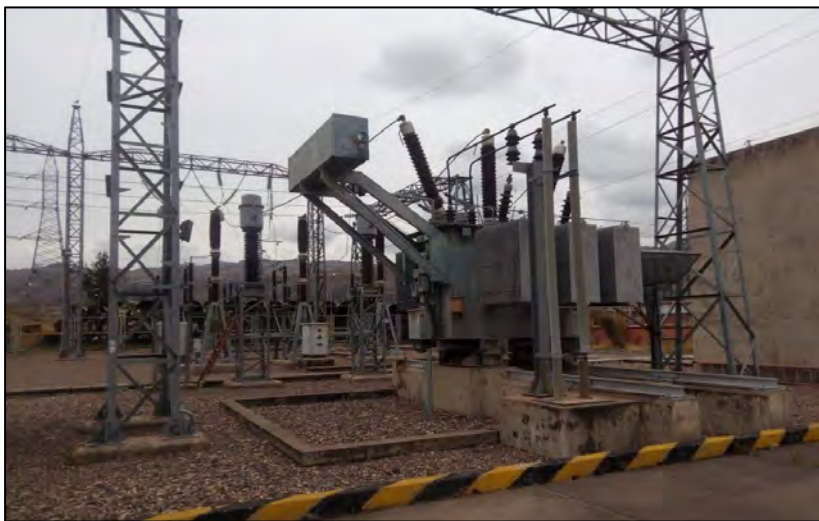
Figura 5 Subestación de transformación Cachimayo-Cusco
