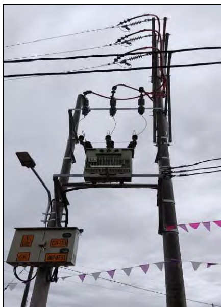
Figura 14 Subestación eléctrica biposte S.E. cod. 007 0731 alimentador CA-03
