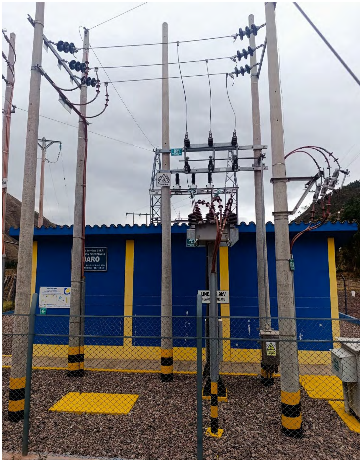
Figura 1.5 Patio de llaves de la Subestación Eléctrica Huaro.
