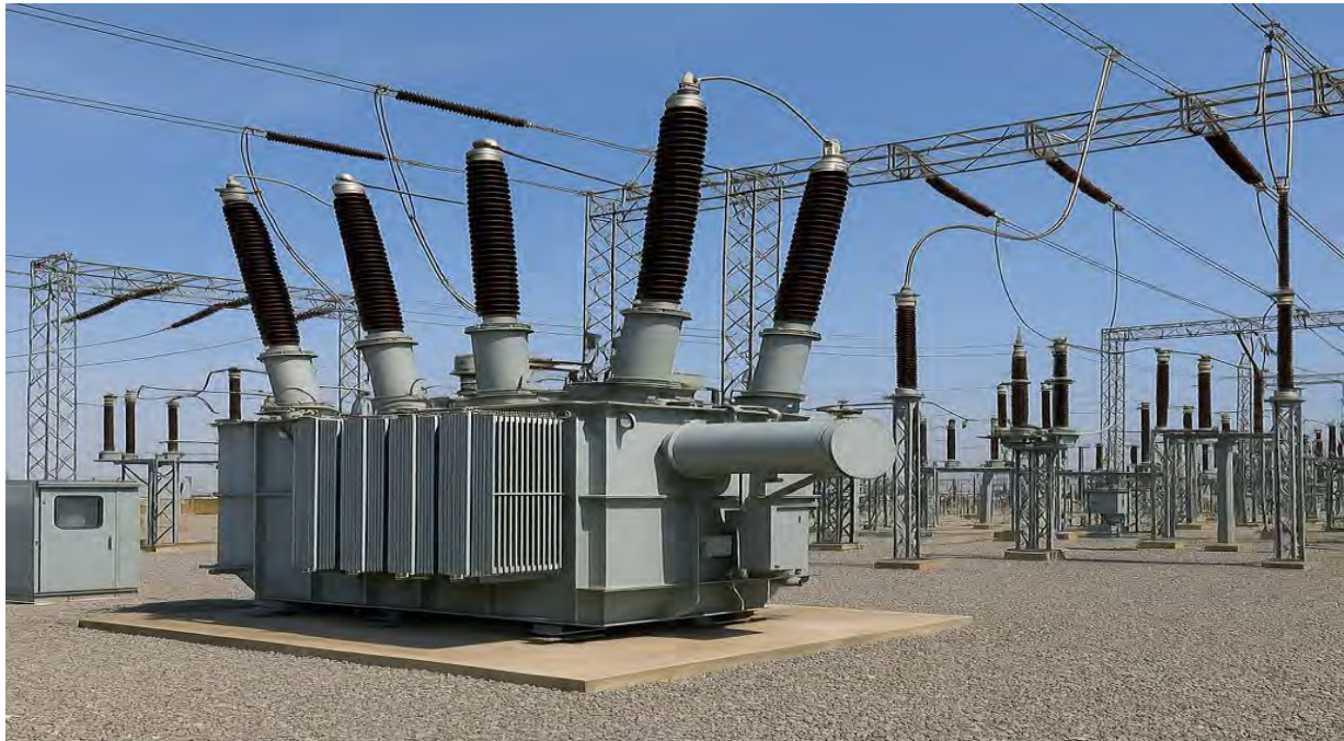
Figura 2.2. Transformador de potencia de la subestación de Planta Solar Rubí (Moquegua).
