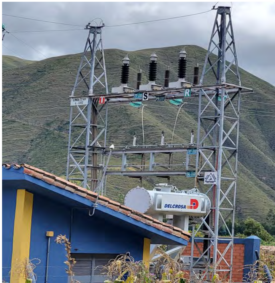
Figura 3.7. Estructura de la subestación de Huaro.
