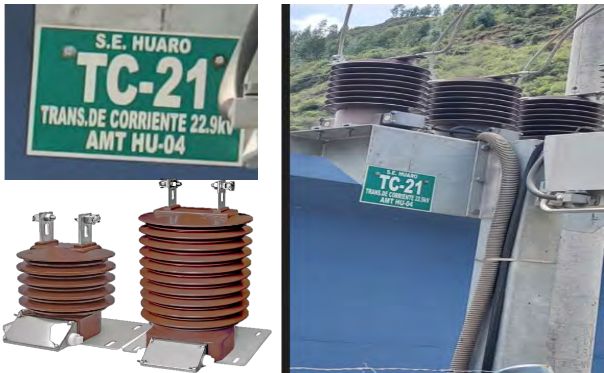
Figura 3.15. Transformador de Corriente de 22.9 kV AMT HU-04.
