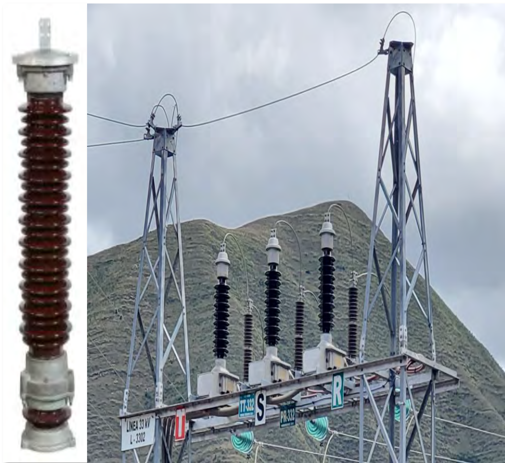
Figura 3.8. Dispositivos de protección de la subestación de Huaró.
