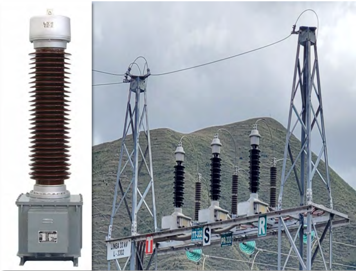
Figura 3.10. Transformadores de Corriente.
