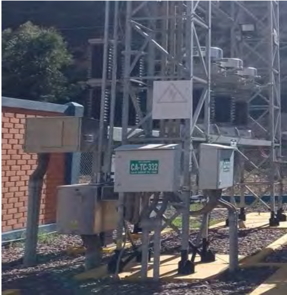
Figura 3.12. Interruptores de Potencia de la subestación de Huaro.
