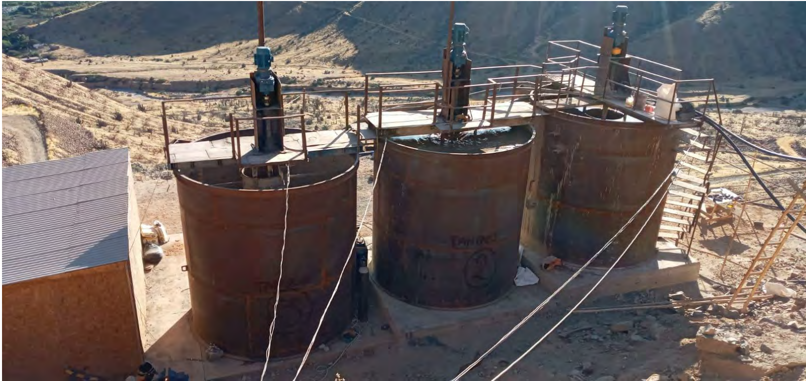
Tanques 12x12 del circuito de cianuración
