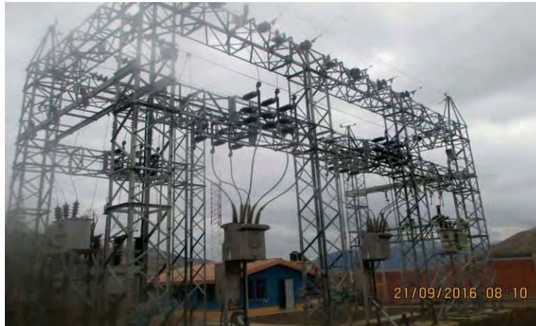
Figura 4.3 S.E. Paucartambo. Barra de 22.9 Kv y salidas PA-01 y PA-02.
