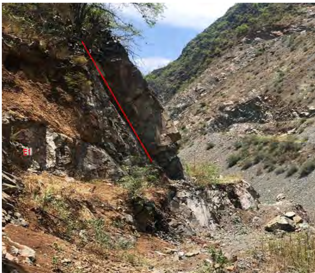
Figura 74: Taludes desfavorables con diaclasamiento producto de la falla Kutuctay.
