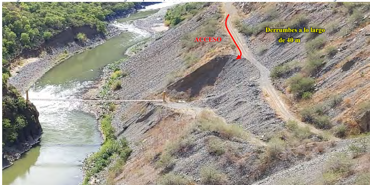
Figura 68: Análisis del talud de la margen izquierda, observando derrumbes de rocas con sedimentos a lo largo de 40m.
