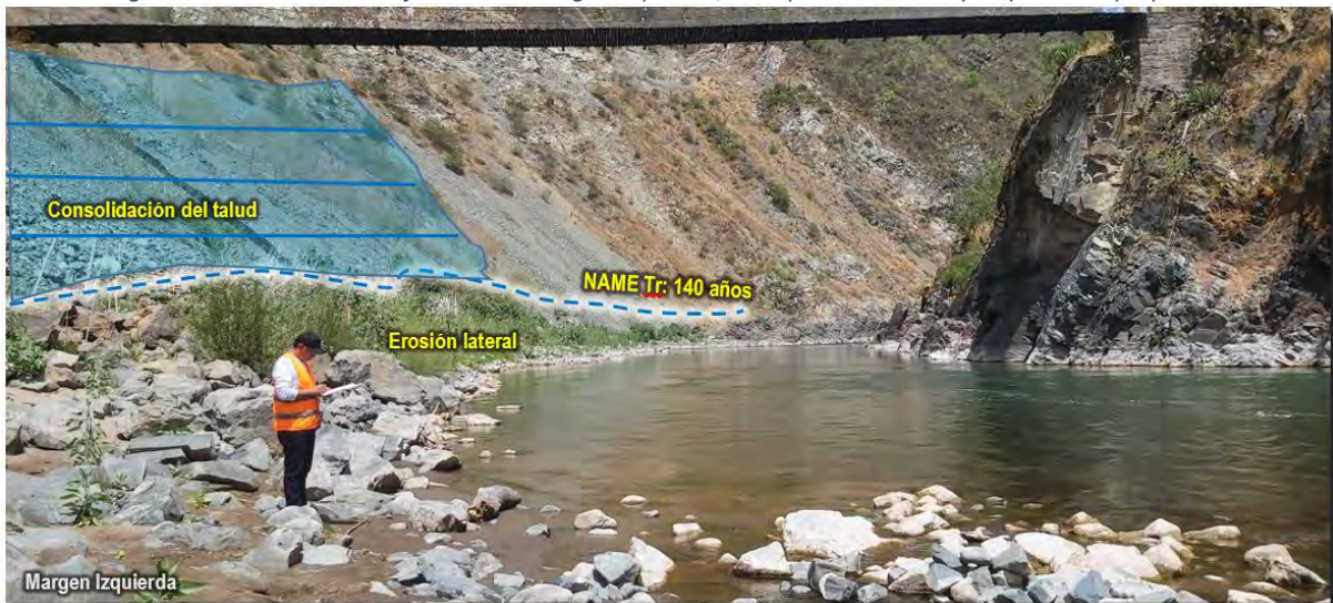
Figura 70: Vista del talud inferior de la margen izquierda, susceptible a erosión y esquema de propuesta.
