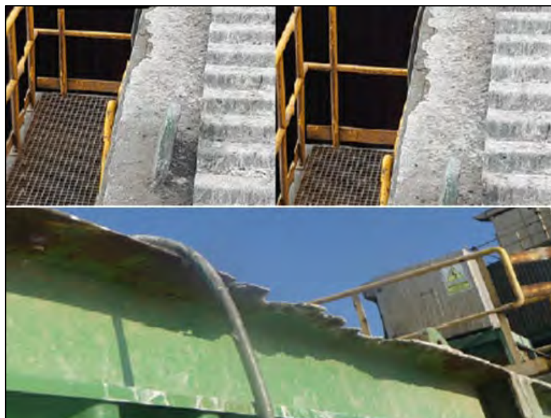
Figura 2. Mecanismo de falla por corrosión en elementos de la estructura.
