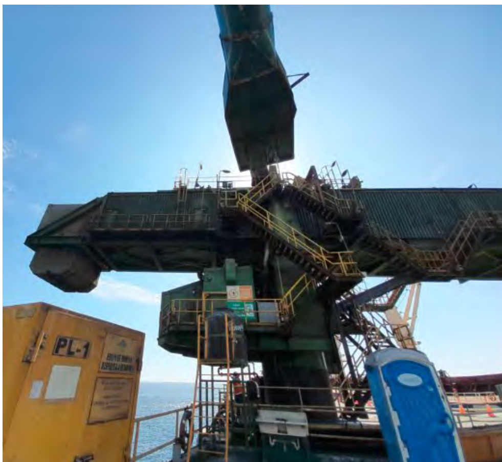
Figura 64. Vista lateral derecha (de frente) del Shiploader. Fuente: Foto proporcionado por la empresa Makyl E.C.S. (2023).
