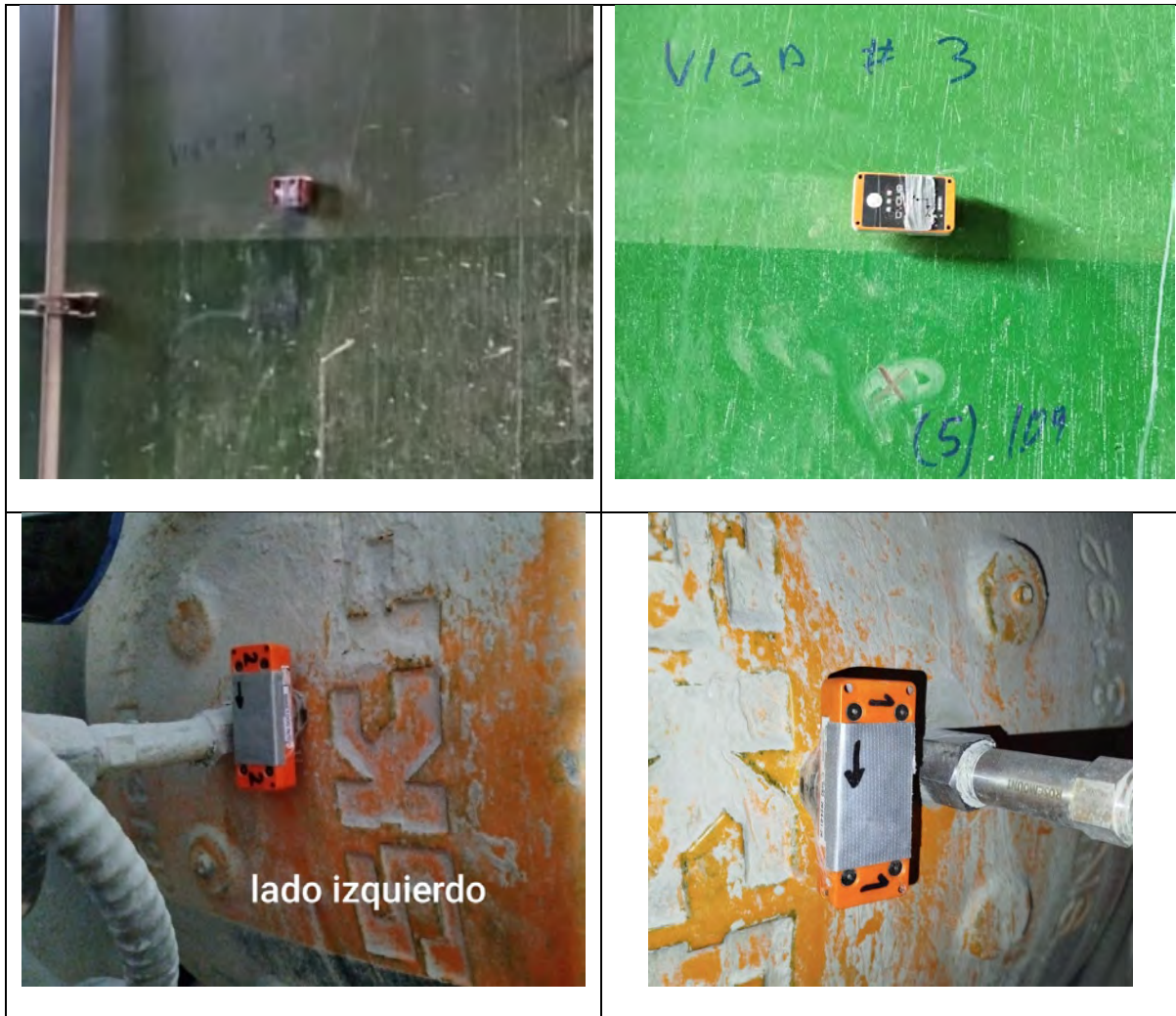
Anexo J. Instalación de sensores (Acelerómetros) sobre la estructura del Shiploader
