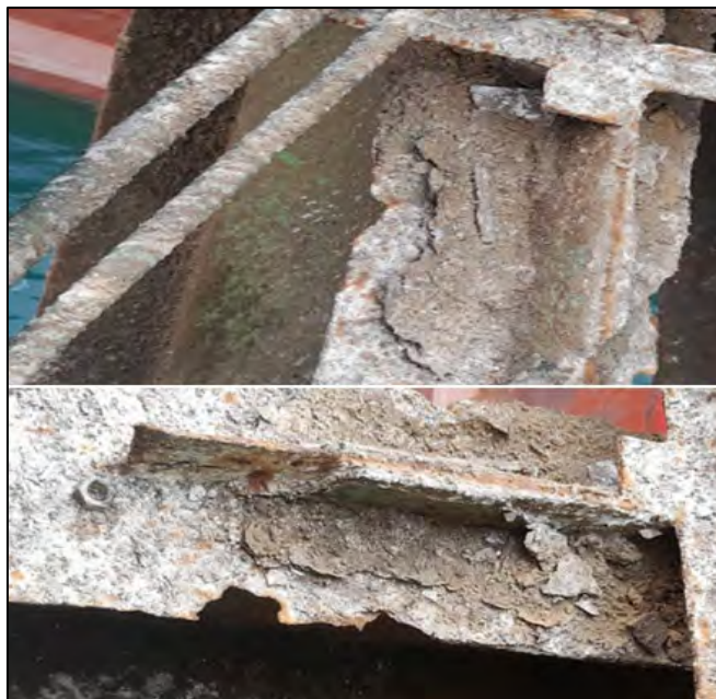
Figura 3. Presencia de corrosión en elementos de la estructura.
