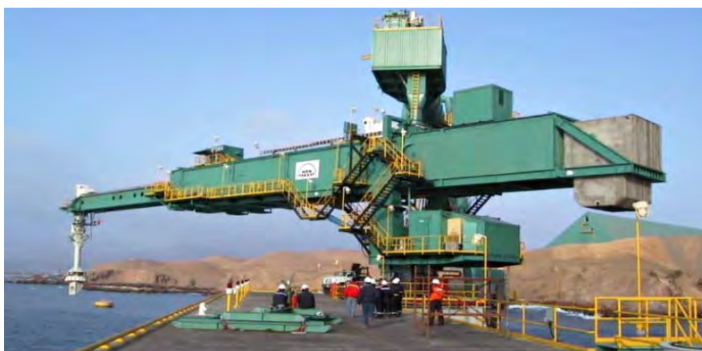
Figura 8. Estructura Shiploader de 1600 Ton/hora de capacidad, compañía minera Antamina.
