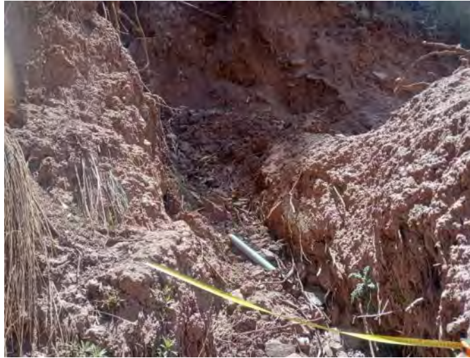
Anexo 1.4: Inestabilidad por erosión y pobre vegetación.
