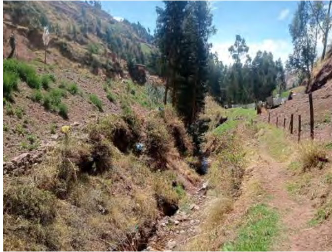
Anexo 1.9: Terreno inestable cerca del rio Wintaray, pendiente fuerte, deslizamiento inactivo.
