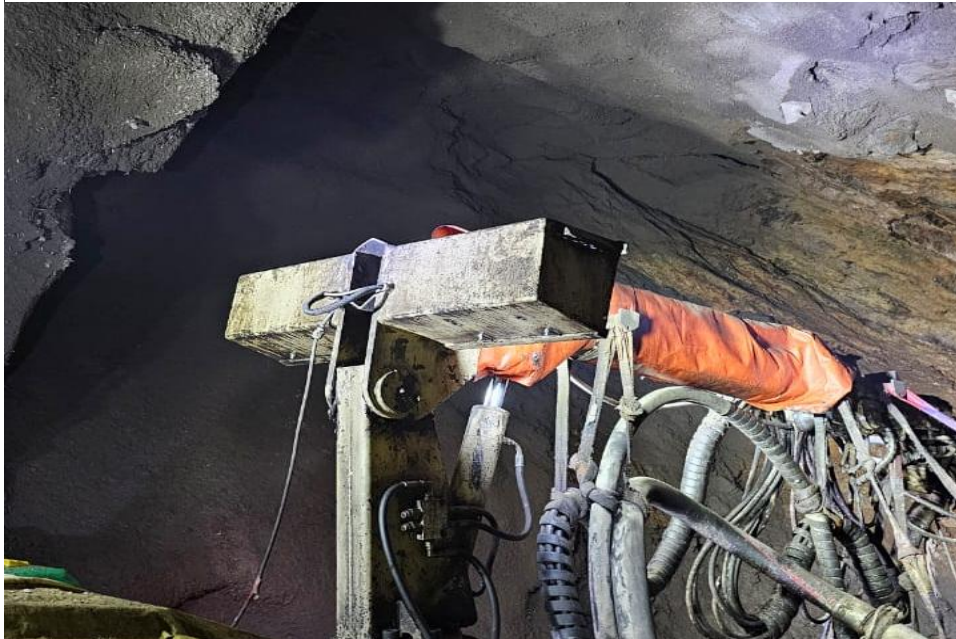
Figura 32. Formación de cuñas en la corona, riesgo de desprendimiento
