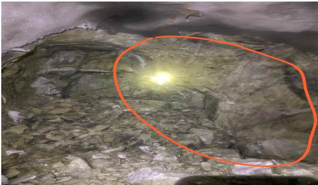
Figura 30. Resultado deficiente de voladura
