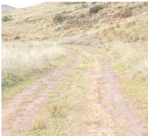
Ilustración 28. Ahuellamiento y camino sin obras de drenaje - tramo 2 - comunidad de Huasampata.
