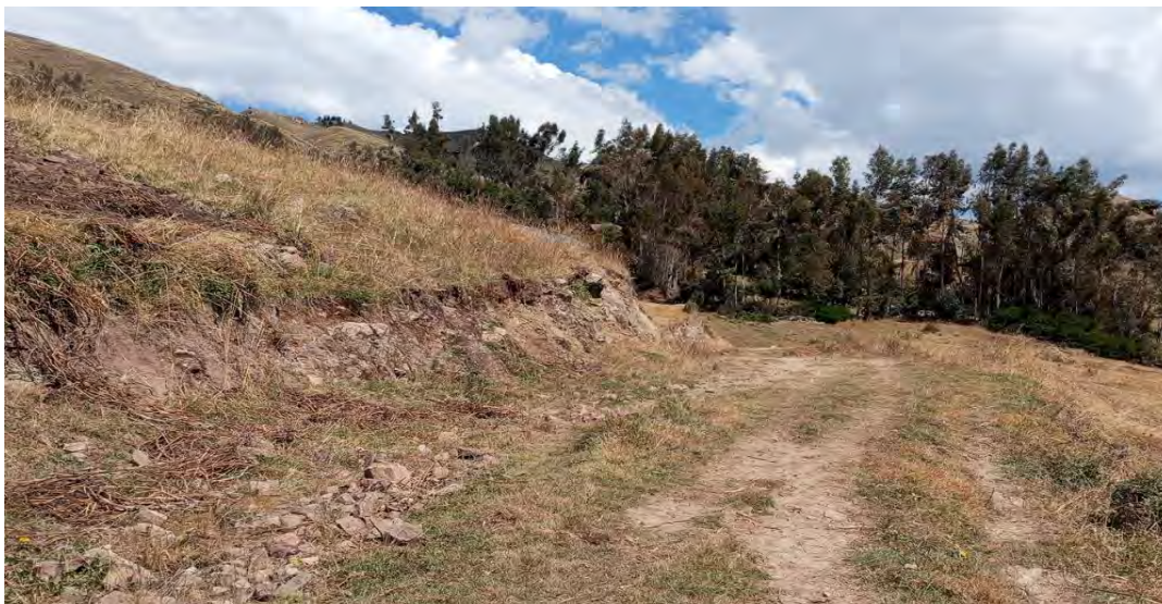
Ilustración 10. Camino rural sin obras de drenaje. Comunidad de Huasampata.
