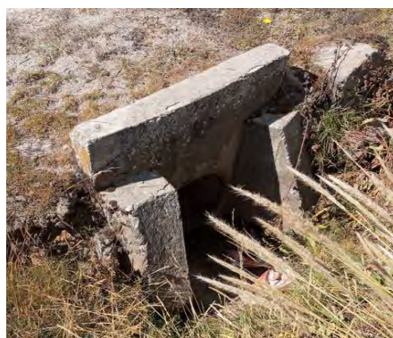
Ilustración 20. Alcantarilla sin limpieza en el trayecto del camino rural.
