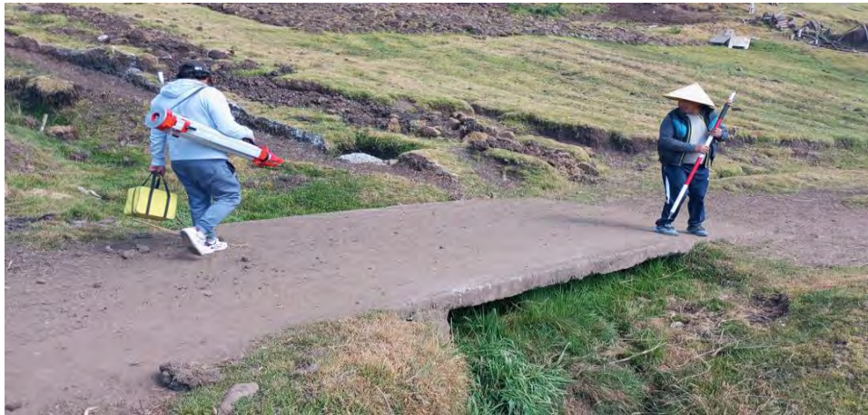
Ilustración 8. Estado actual Pontón 02. Comunidad de Huasampata.
