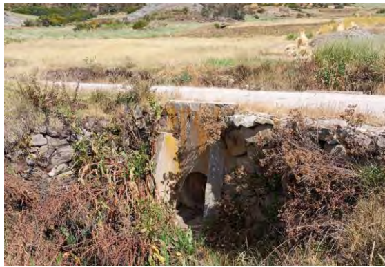
Ilustración 17. Alcantarilla deteriorada y en mal estado de conservación.
