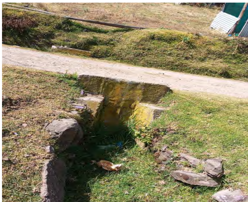
Ilustración 6. Estado actual de alcantarillas. tramo 01 dentro de la comunidad de Huasampata.
