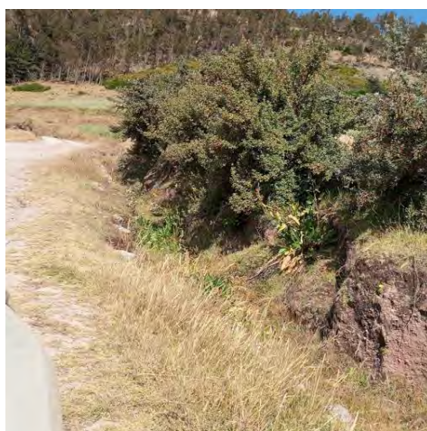
Ilustración 21. cunetas totalmente erosionadas. Trayecto del camino rural existente.
