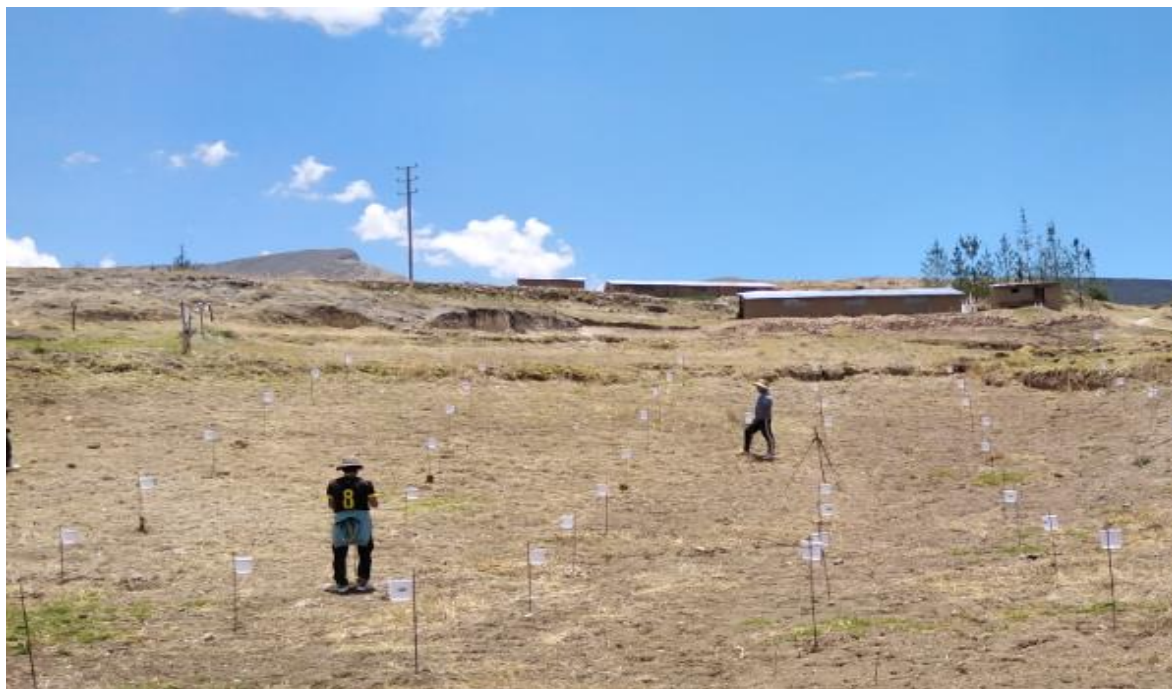
Anexo: 14 Instalación de las parantes portas colectores pluviométricos en parcela con pendiente de 21.50 %.
