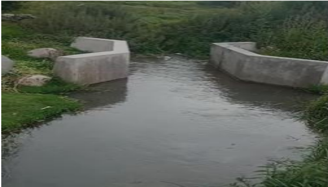
Anexo 23: Captación del sector de Huaycco lleno de restos vegetales.
