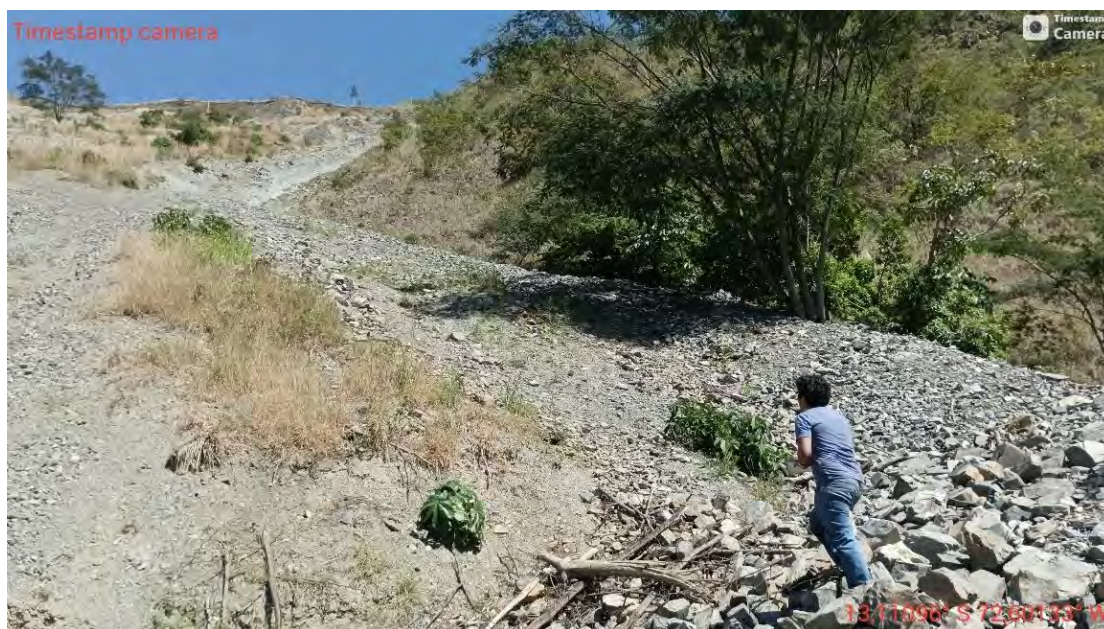
Foto 33_Muro de contención, y material retenido.
