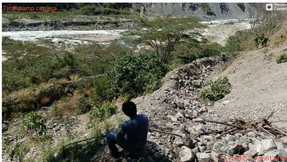
Foto 31_Caida de rocas y evidencia de poca vegetación
