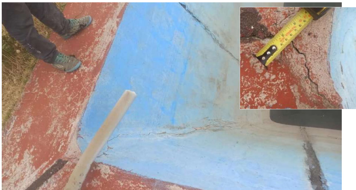
Figura 122. Fisuras desarrolladas por asentamientos en el reservorio antiguo en el área del nuevo reservorio 04 proyectado
