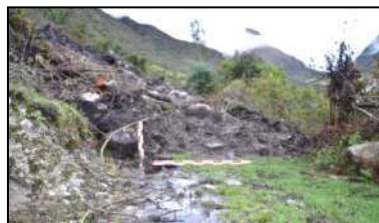
Detalle del camino declarado, afectado por los trabajos realizados en la carretera.
