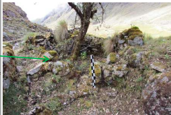
Fotografía recinto N° 3: Esta estructura se encuentra apuntalada al interior quedando en pie solo el vano de ingreso.
