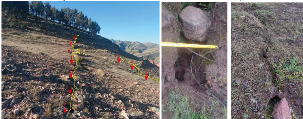
Figura 47. Grietas de tracción en la cabecera del deslizamiento “DsQ-01”
