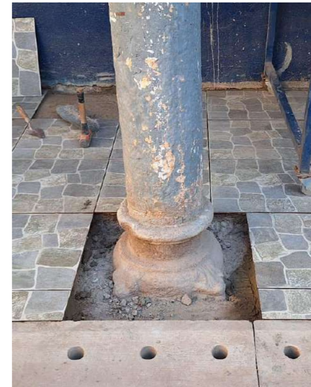
Figura 43. Evidencia expuesta de basa de columna
