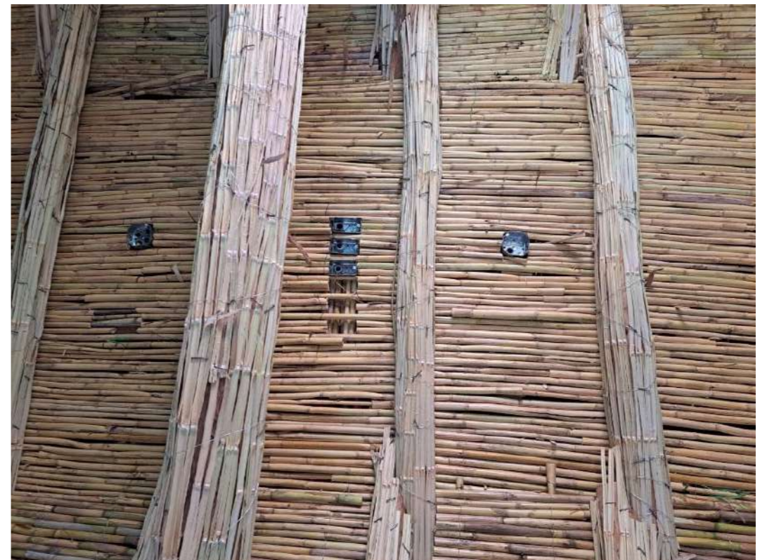
Figura 14. Instalaciones eléctricas y comunicaciones - amb. 218
