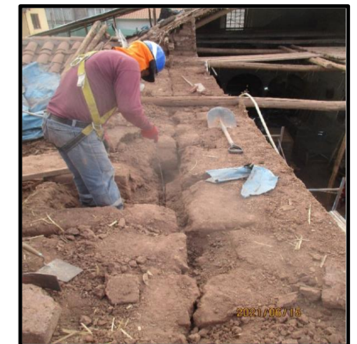
FIGURA 47: EVIDENCIA DESPLOME DE MURO EPÍSTOLA
