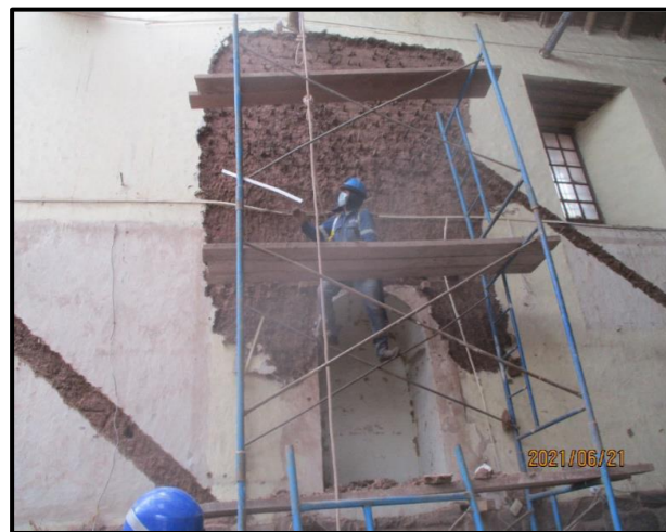
FIGURA 44: CALAS EXPLORATORIAS EN MURO CON "CRUZ DE SAN ANDRÉS", LIBERACIÓN DE EMBARRE TRAS EVIDENCIAR ESTACAS
