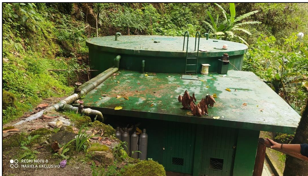
Figura 118. Reservorio de aguas superficiales para consumo humano.
