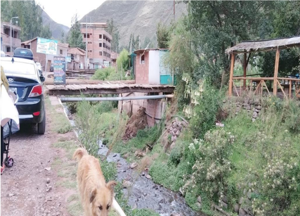
Figura. 25 piscigranja “Los Frutales”, tuberías al costado de la Piscigranja.
