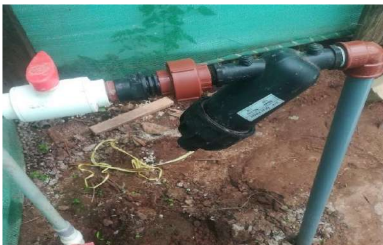
Fotografía N°18: Sistema de filtrado (filtro de anillos).
